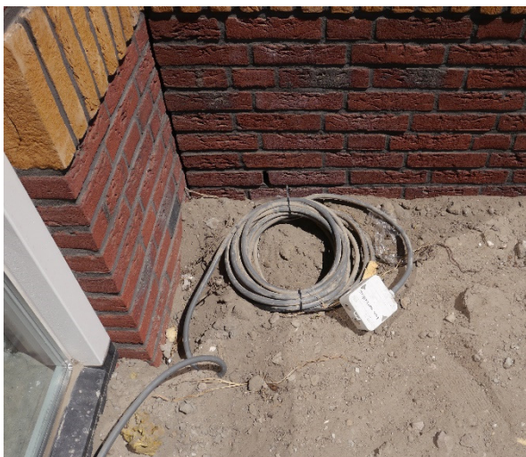
Elektra op rol ten behoeve van tuinverlichting (2C25/2C26)
