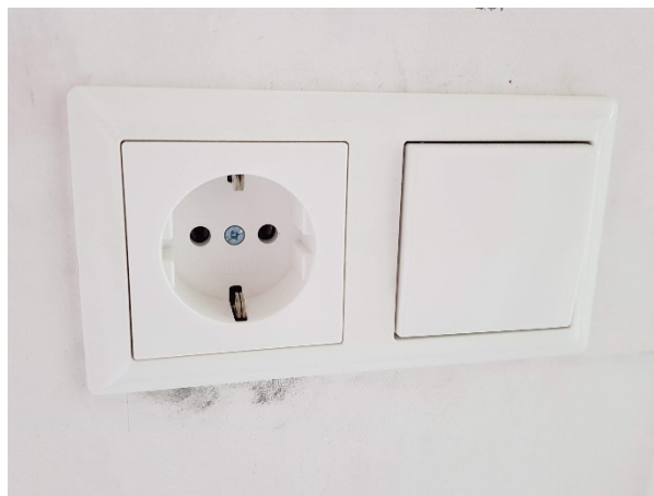
Wandcontactdoos naast schakelaar (2C05)
