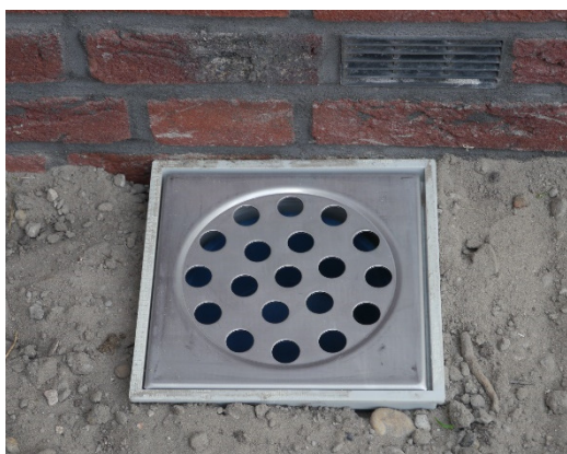
Afvoerput buitenkraan (2B03)
