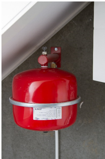
Expansievat (technische ruimte)
