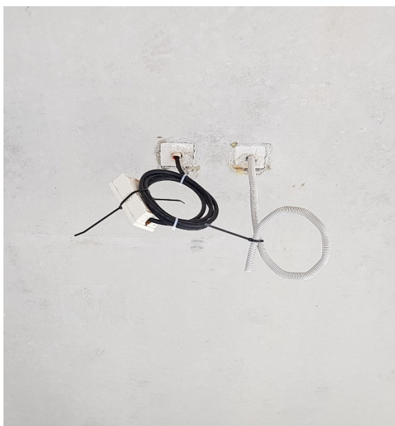
Aansluiting beamer (2C17)
