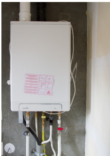
CV-ketel (technische ruimte)
