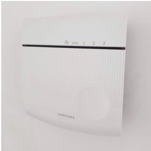
Bediening mechanische ventilatie in woonkamer
