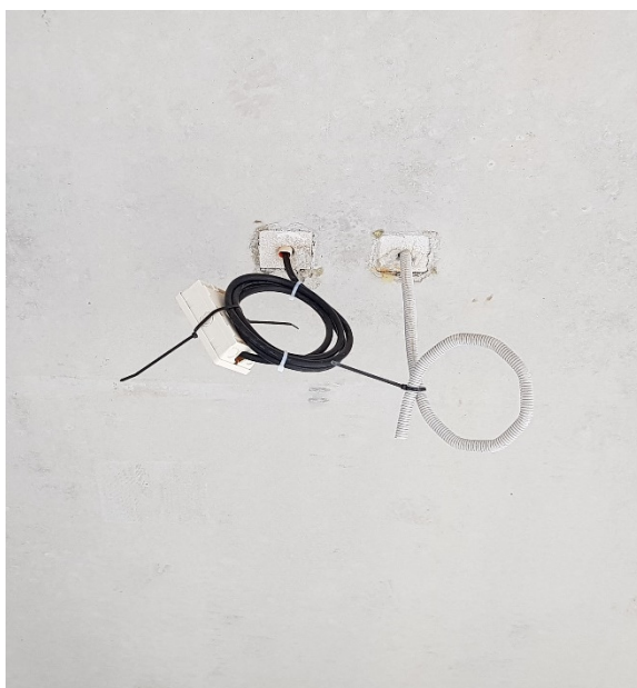
Aansluiting beamer (2C17)
