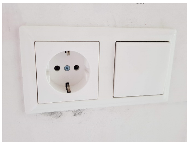
Wandcontactdoos naast schakelaar (2C05)
