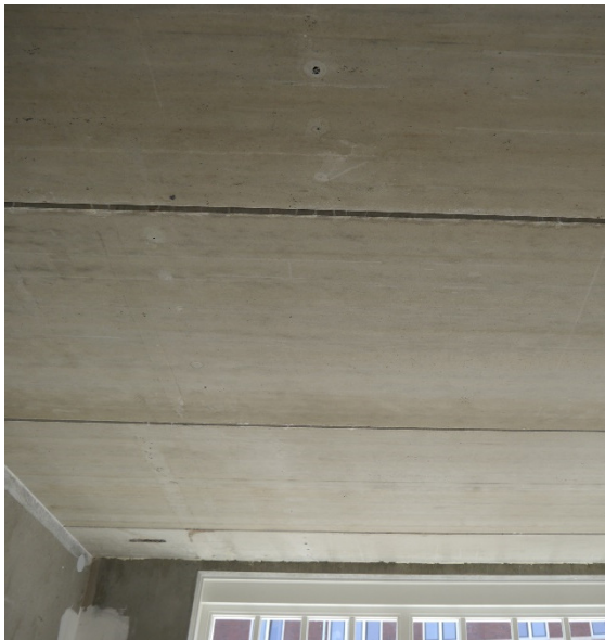
Vervallen spuitwerk plafond
