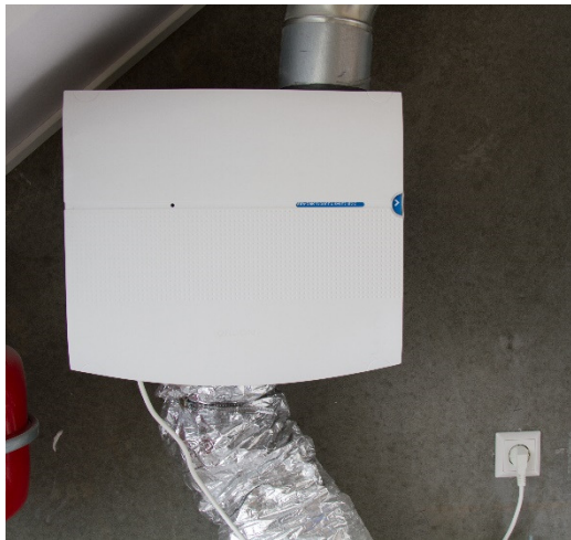
MV-box (technische ruimte)
