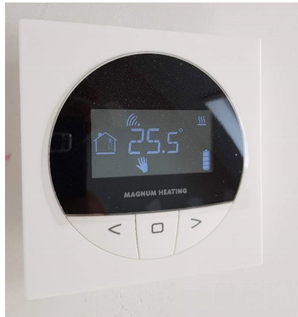
Digitale klokthermostaat (2D30) wordt ook geplaatst bij individuele (na)regeling
